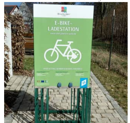
e-Bike-Ladestation bei der Autobahnkirche
